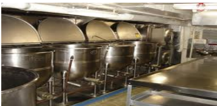
Figura N° 10: Marmitas de cocción al vapor.
