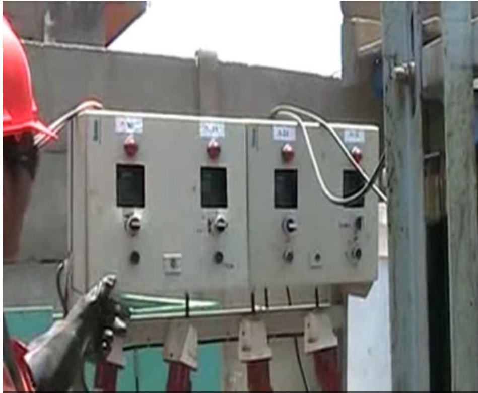
Figura 48. Tablero de los variadores de velocidad de los motores de los mezcladores Fuente: Empresa South Service Engineers
