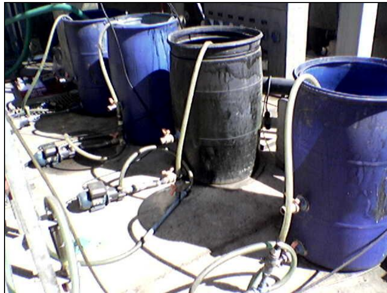
Figura 53. Estanques de orgánico y bombas de impulsión Fuente: Empresa South Service Engineers
