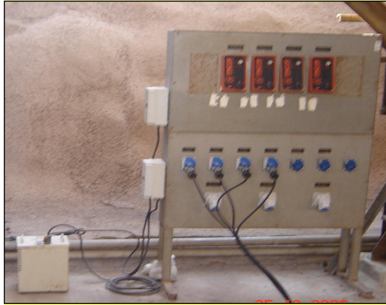
Figura 54. Tablero eléctrico con variadores en su parte superior Fuente: Empresa South Service Engineers
