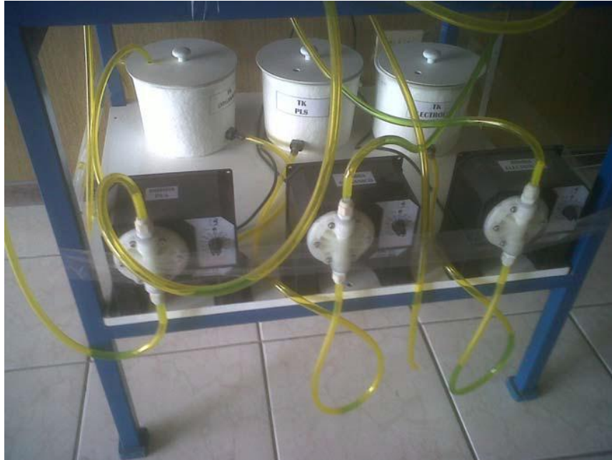
Figura 43. Área de bombas de la alimentación a la planta Fuente: Empresa South Service Engineers
