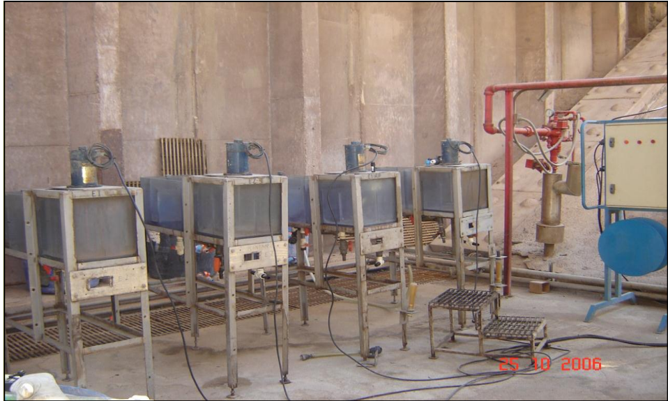
Figura 55. Vista General Planta Piloto Fuente: Empresa South Service Engineers
