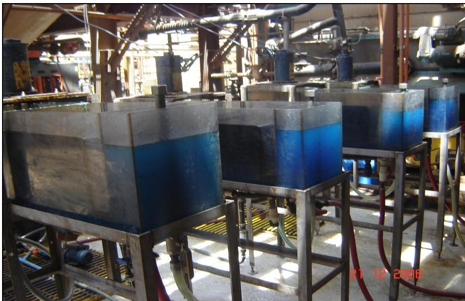
Figura 56. Vista lateral de la Planta Piloto Fuente: Empresa South Service Engineers
