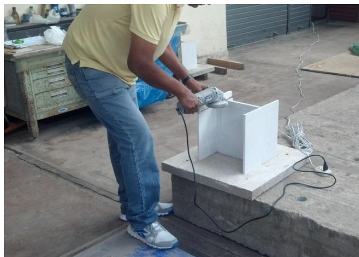
Figura 39. Corte de la parte superior del muro H para posterior vaciado de la losa de concreto
