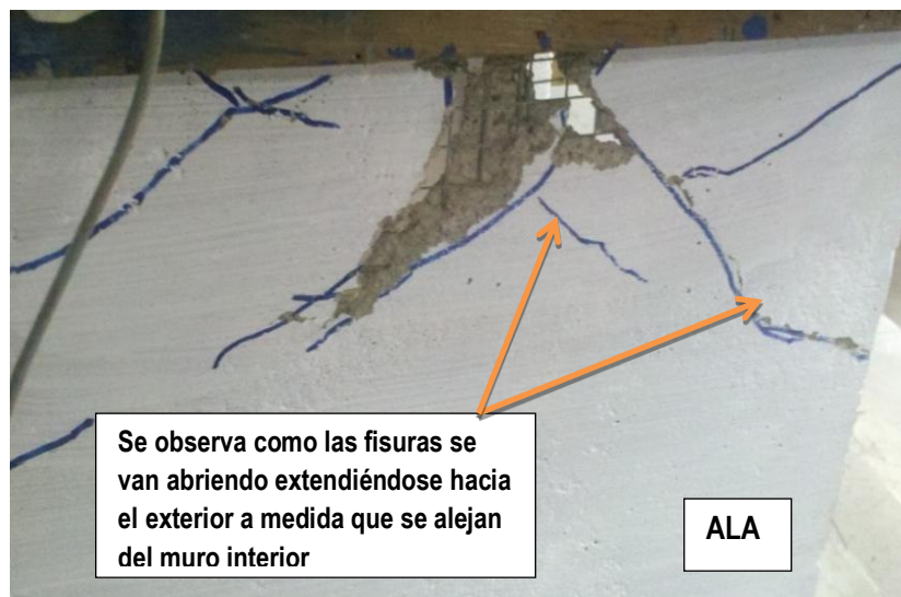
Figura 60. Refuerzo expuesto del ala por el sismo inducido
