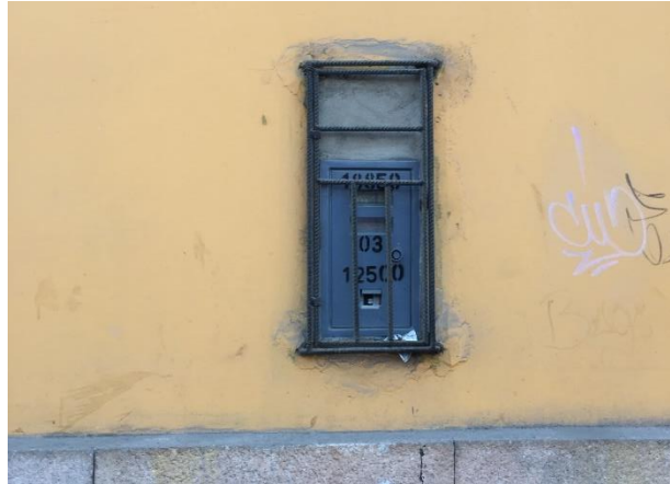
FIGURA 36. MEDIDOR DE LUZ ELECTROSUR S.A.
