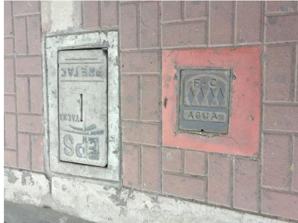
FIGURA 34. CAJA DE MEDIDOR DE AGUA
