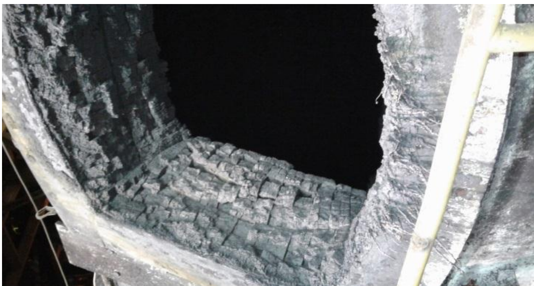
Figura 17. Muestra de ladrillos desgastados parte boca del CPS.
