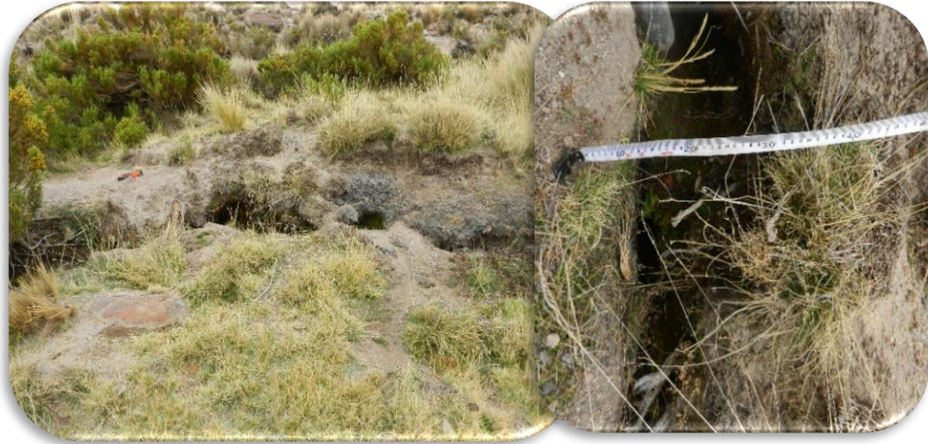
Foto 5. Sector1: Grietas de tensión con abertura de 30 cm, y flujo de agua en la abertura. Elaboración propia
