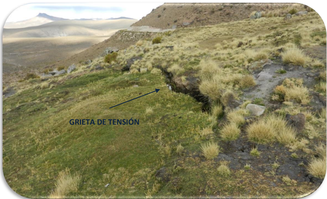
Foto 8. Sector2: Tercer Deslizamiento, grieta de tensión ubicada metros debajo del eje de la línea de conducción. Elaboración propia.
