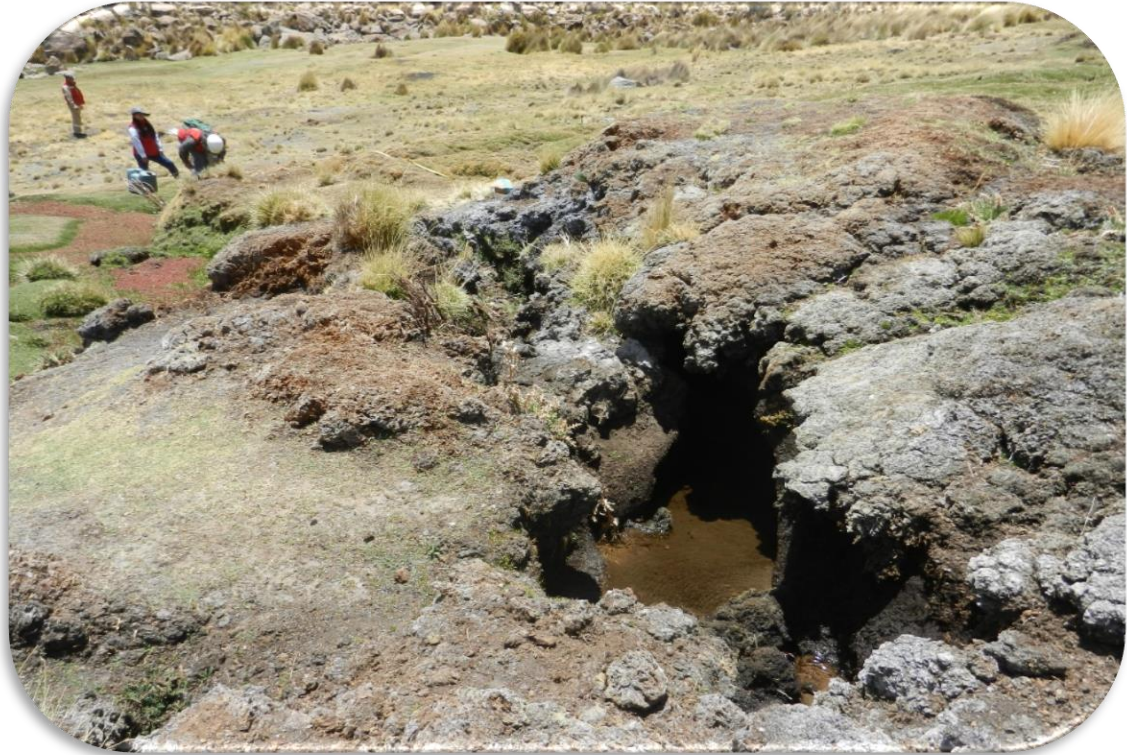
Foto 11. Sector3: Se evidencia movimiento de masa de suelo (reptación), con grietas de tensión y terreno saturado. Elaboración propia.
