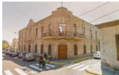
Ex Gobernación: Estado de Edif. Malo
